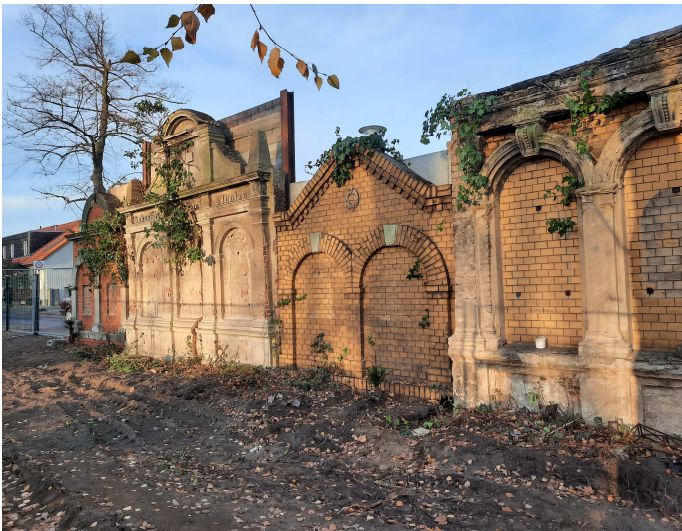
Reste der Erbbebräniswand nach dem Baustopp durch die BVV-Pankow vom 24.11.2020 Foto: Anne Schäfer-Junker, 6.12.2020
